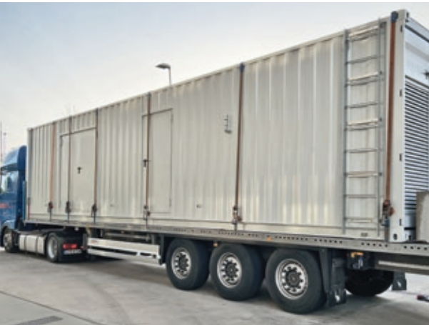
Abbildung 3: Zur Netzersatzanlage umfunktionierter Überseecontainer
