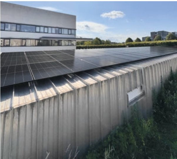
Abbildung 5: Die 2024 installierte Photovoltaikanlage auf den Dächern der CVUA-Garage
